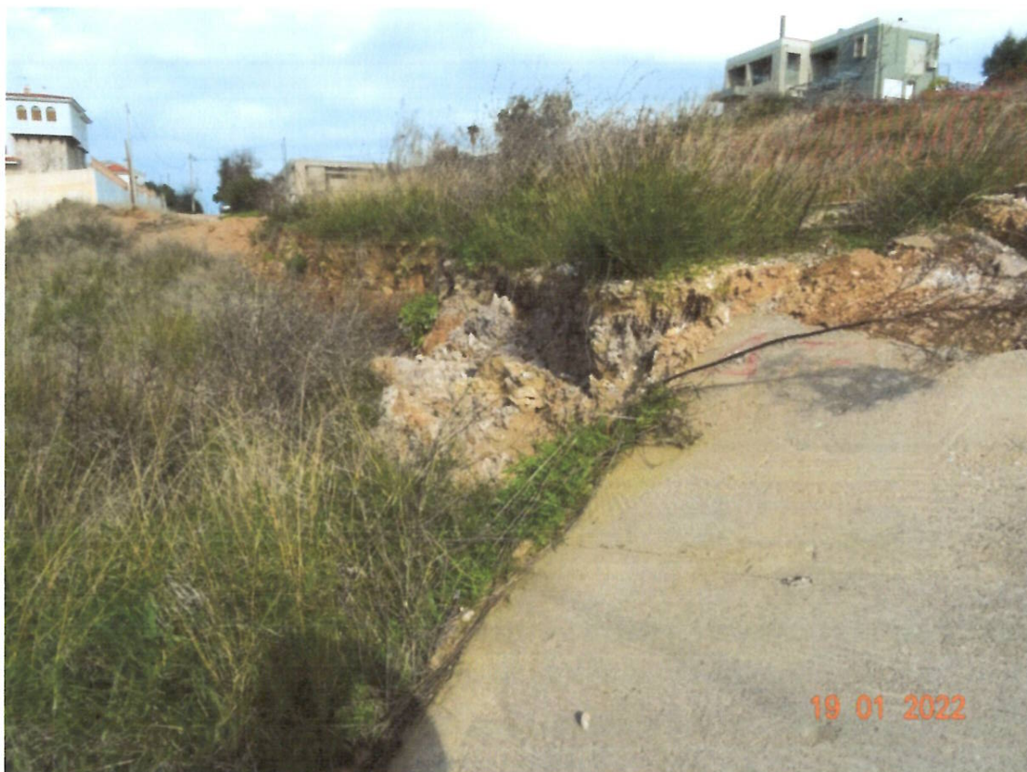
Φωτ.1. Γενική άποψη της κατολίσθησης, διακρίνεται η περιοχή που έχει επηρεαστεί από το φρύδι του φυσικού πρηνούς προς τα κατάντη.
