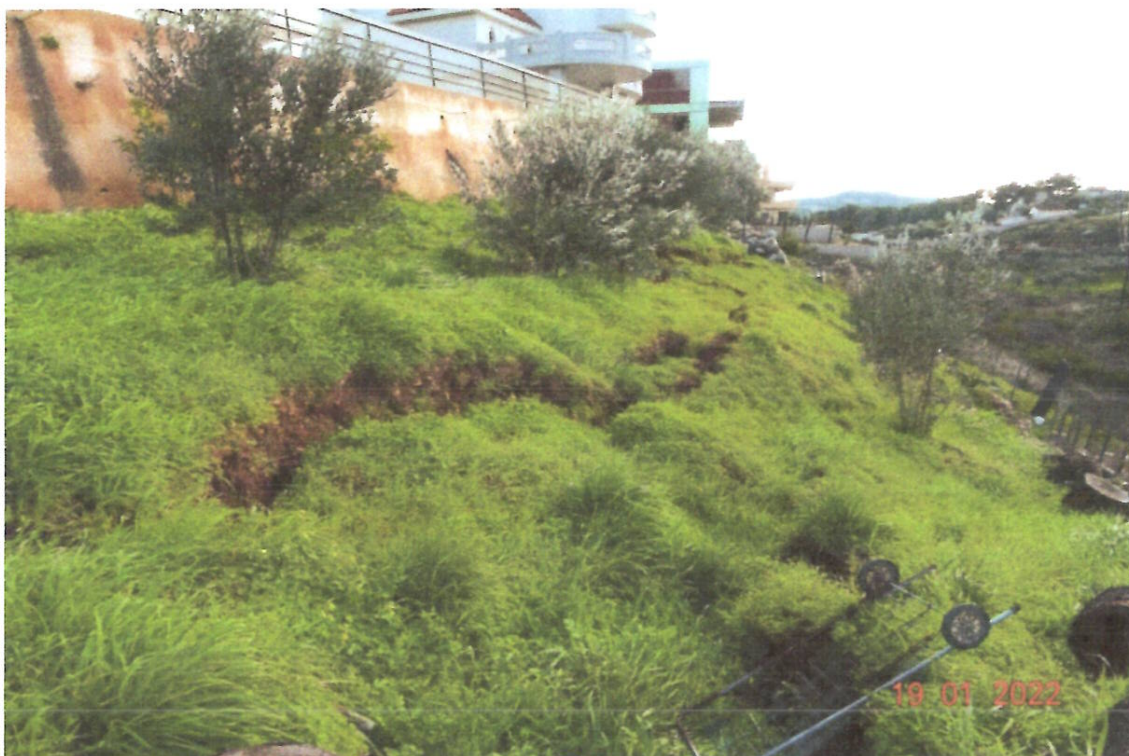
Φωτ.3: Κλιμακωτές ρωγματώσεις στο πράνις αμέσως κατάντη της κατοικίας της οδού Καρυωτάκη 8.
