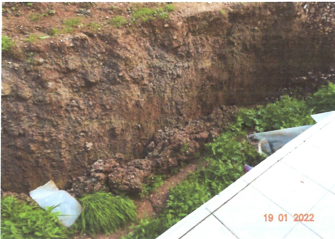
Φωτ.2: Κάθετη μετατόπιση μήκους 1,0m περίπου με διολίσθηση – καταβύθιση του κατάντη τεμάχου της ρωγμάτωσης.
